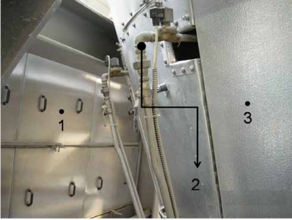
Fotoğraf 4. C fırını silosu yalıtım ve hava nozulu yerleşimi. 1.Fırın ile silo arası yalıtım duvarı 2.Sil konisi hava nozulları 3.Fırın silosu dış yalıtımı
